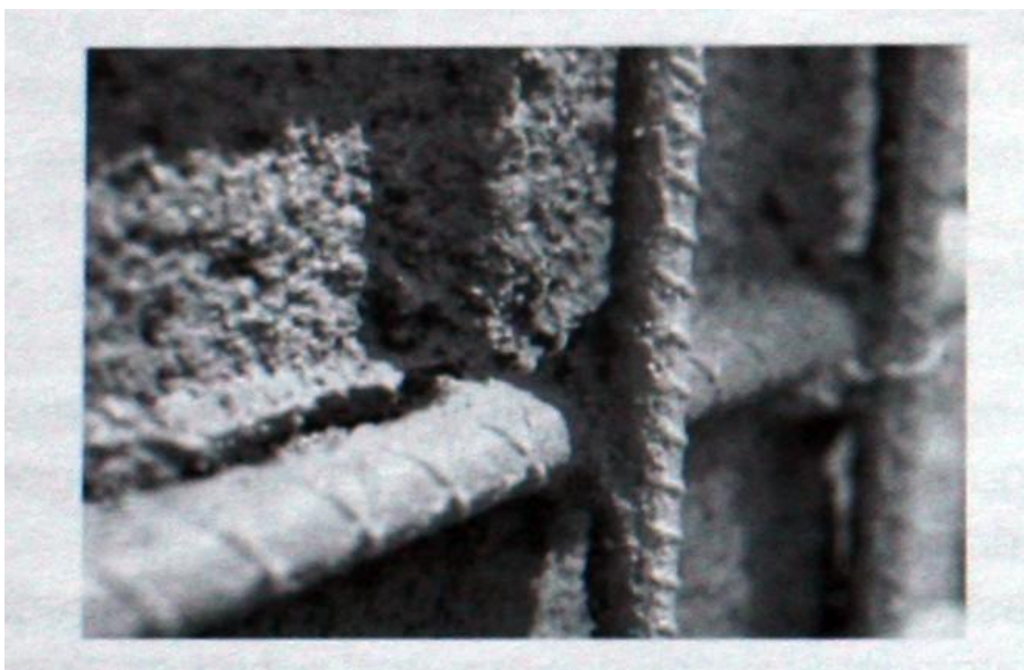
Рис 8.13 Еще один пример удачной укладки. Обратите внимание на равномерность укладки смеси и как образуются ребра за стержнями.
